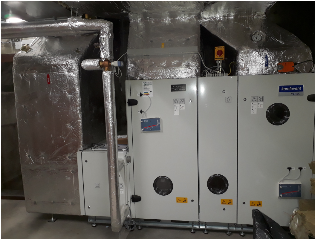
Hier sieht man die bestehende Lüftung, welche im Jahr 2019 mit der Kirchensanierung eingebaut wurde.
