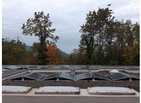
Abbildung 7: Solaranlage auf dem Dach des Kirchenzentrums
